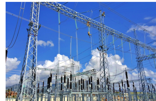
Dự án điện mặt trời BIM - Ninh Thuận
